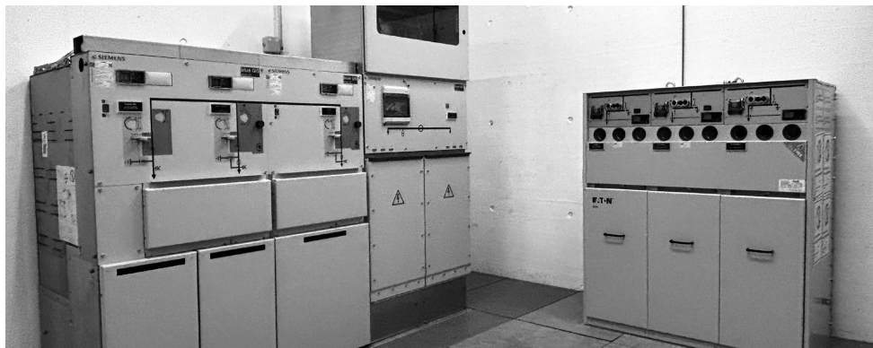
Mittelspannungsschaltanlage SK Hebbag
