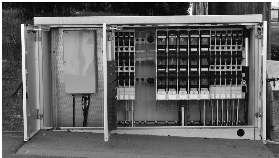
Verteilkabine Brenngrüttistrasse mit Glasfaserabteil
