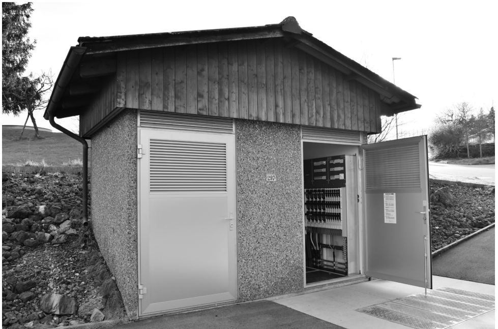
Transformatorstation Sonnenberg an der Lohstrasse
