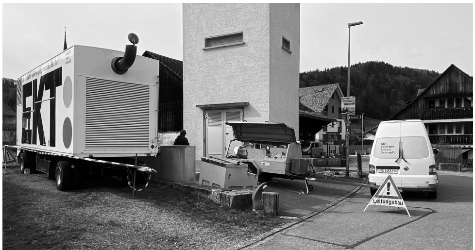
Notstrom einspeisung Transformatorstation Dorf
