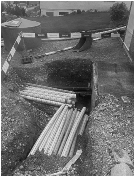
Leerrohre beim Vorschacht an der Transformatorstation Sonnenberg
