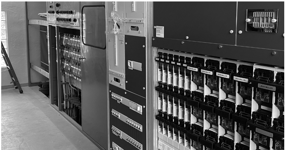
Niederspannungsverteilung Transformatorenstation Schulacker alt und neu
