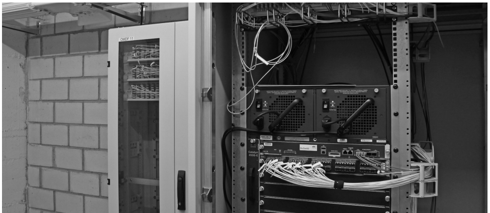
Glasfaserzentrale Bichelsee POP
