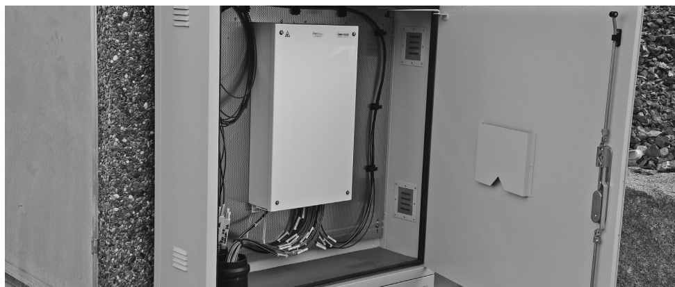
Glasfaserverteiler Sektor Lohstrasse
