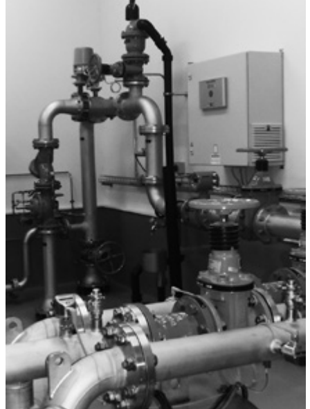
Innenbereich Pumpenhaus Espiriet
