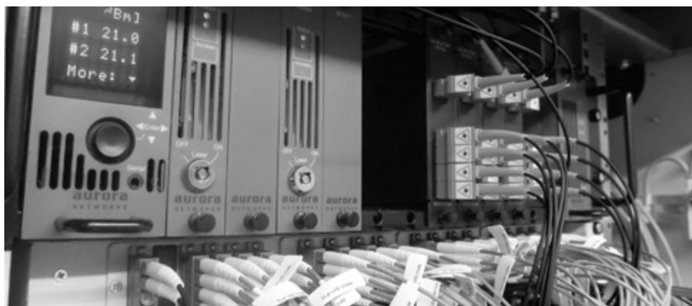
Verstärker Fernsehsignal Zentrale (POP)
