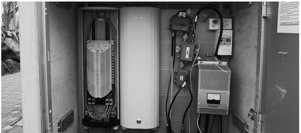
Verteilpunkt Kommunikationsnetz, links FTTH/rechts Koax
