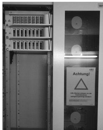
Verteiler LWL-Leitung Balterswil-Ifwil
